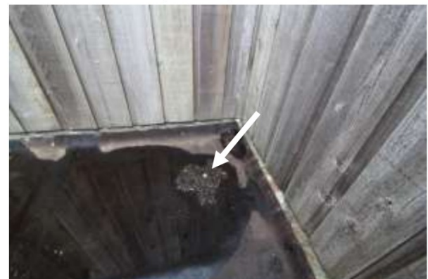
Asbesthoudend mos, op dak carport
