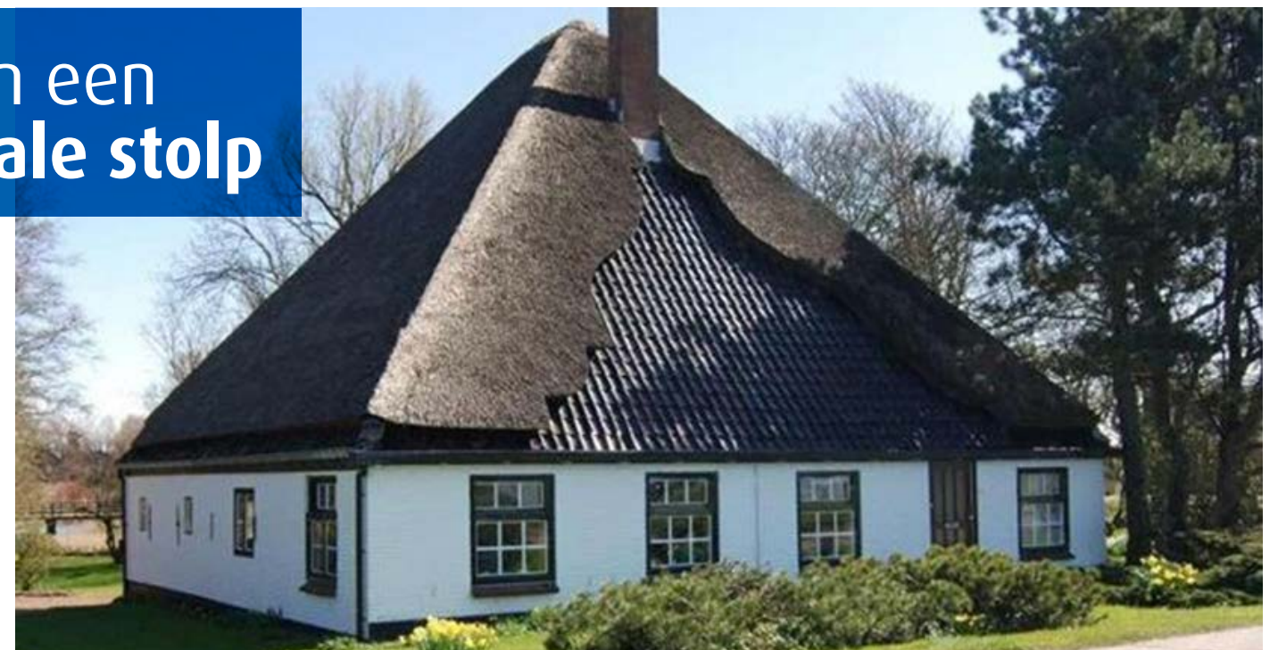
Kanaaldijk 273, Koedijk, gemeentelijk monument (eind negentiende eeuw) "De oude eerste etagevloer is nu het plafond van de tweede"
