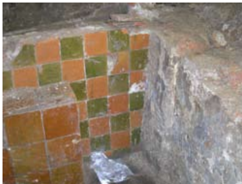
Afb. 40-41 De recht-hoekige kelder 3E, na-derhand diverse malen hersteld wegens verzak-king en lekkages, was van oorsprong betegeld met rode en groen geglaazuurde plavuizen (gezien uit het westen)
