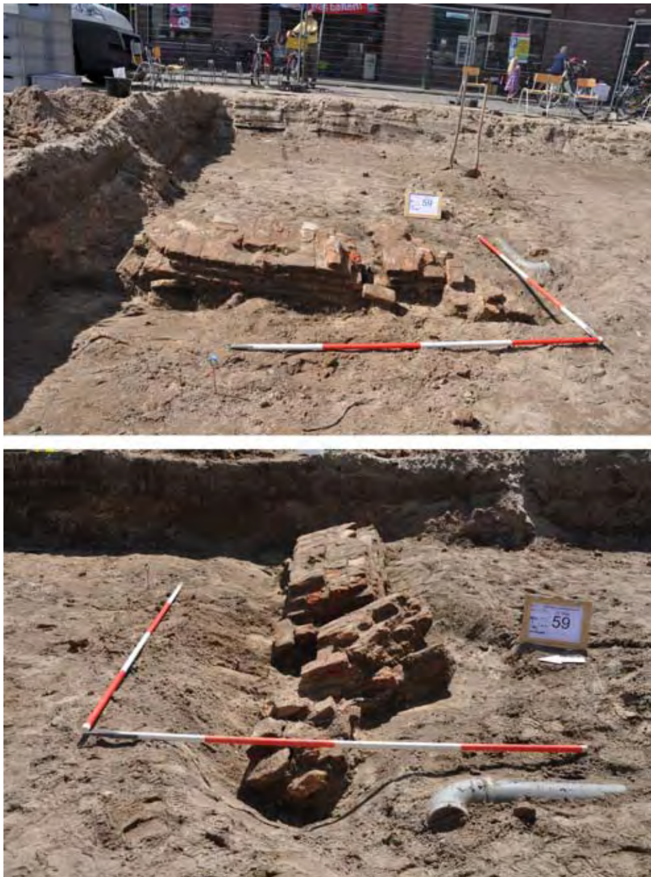
Afb. 4.21 De funderingen s. 377 en s. 379. Het muurwerk van de fundering is danig verzakt, waarschijnlijk door het neerhalen van de muren bij de sloop waarbij de bakstenen meestal voor hergebruik bestemd werden
